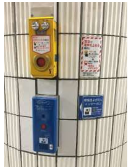
横浜駅非常停止ボタン・インターホン
