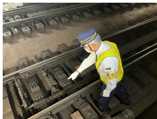
保安装置故障訓練の様子
