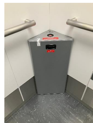
エレベーター防災キャビネット
